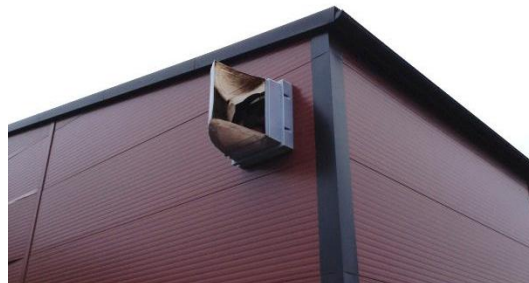
Figur 6. Utlopp för frånluftsfläkten. Utloppet skyddas av en huv monterad i 90° vinkel.
