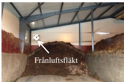
Figur 5. Frånluftsfläkt i förkomposten.
