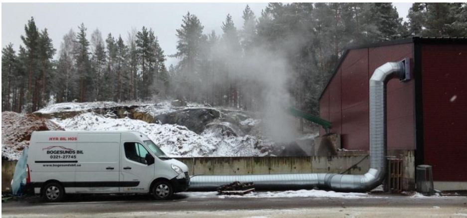
Figur 12. Rördragning från frånluftsfläkt. Mätpunkten i röret är precis bakom skåpbilen. Skåpbilen användes som mätlaboratorium och innehöll logger och analysutrustning för gasemissioner.
