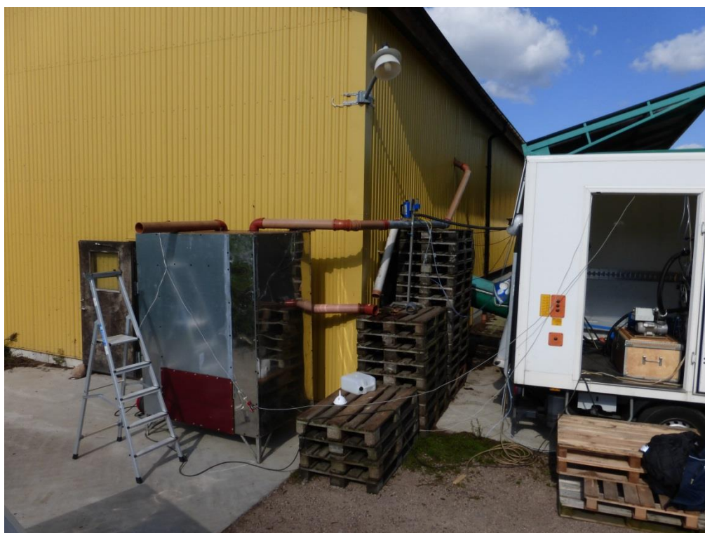
Figur 17. Till vänster värmeväxlaren med dimensionerna 1,2 \times 1,6 \text{ m}^2 i bas och 2,5 \text{ m} i höjd placerad på Mellby gård. På Wiggeby fanns det också en enkel ammoniakfälla monterad i inloppet till värmeväxlaren, där ingående luft sprayades med vatten ( 6 \text{ liter/h} ).
