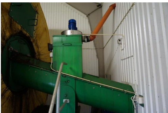
c) Frånluftsfläkt monterad på inmatningsskruven.
